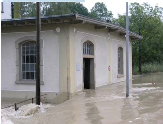
Wasser fliesst durch die Türe statt die Turbine
