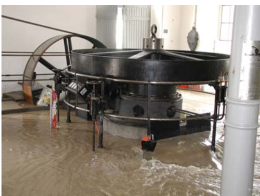
Knietiefes Wasser im Maschinenraum
